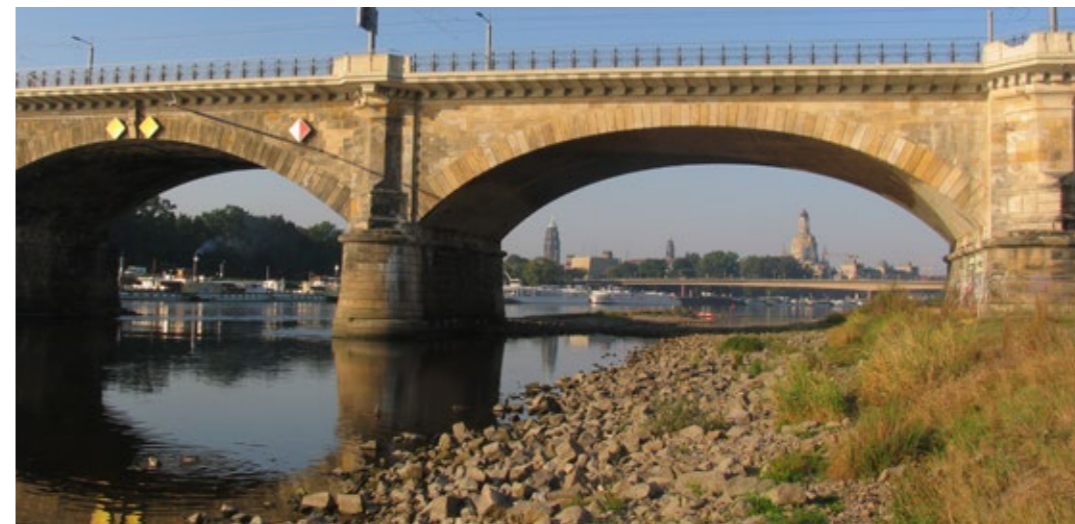
POSTAER SANDSTEIN, Albertbrücke, Dresden
