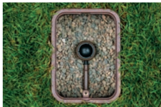
Automatisches Spülventil installiert
