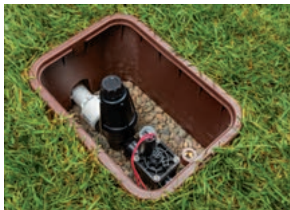
PCZ-101 in einer Mehrzweck-Box installiert
